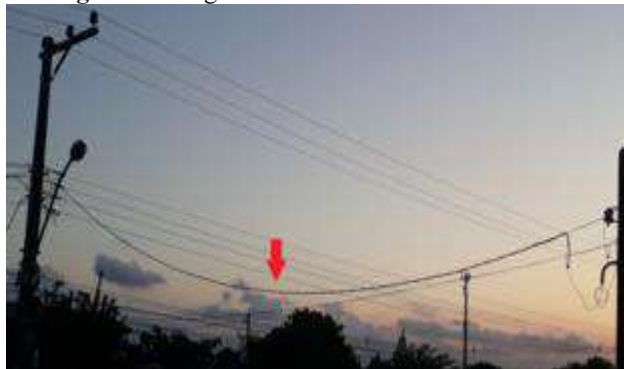
Figura 5. Imagem de cabo de transmissão elétrica
